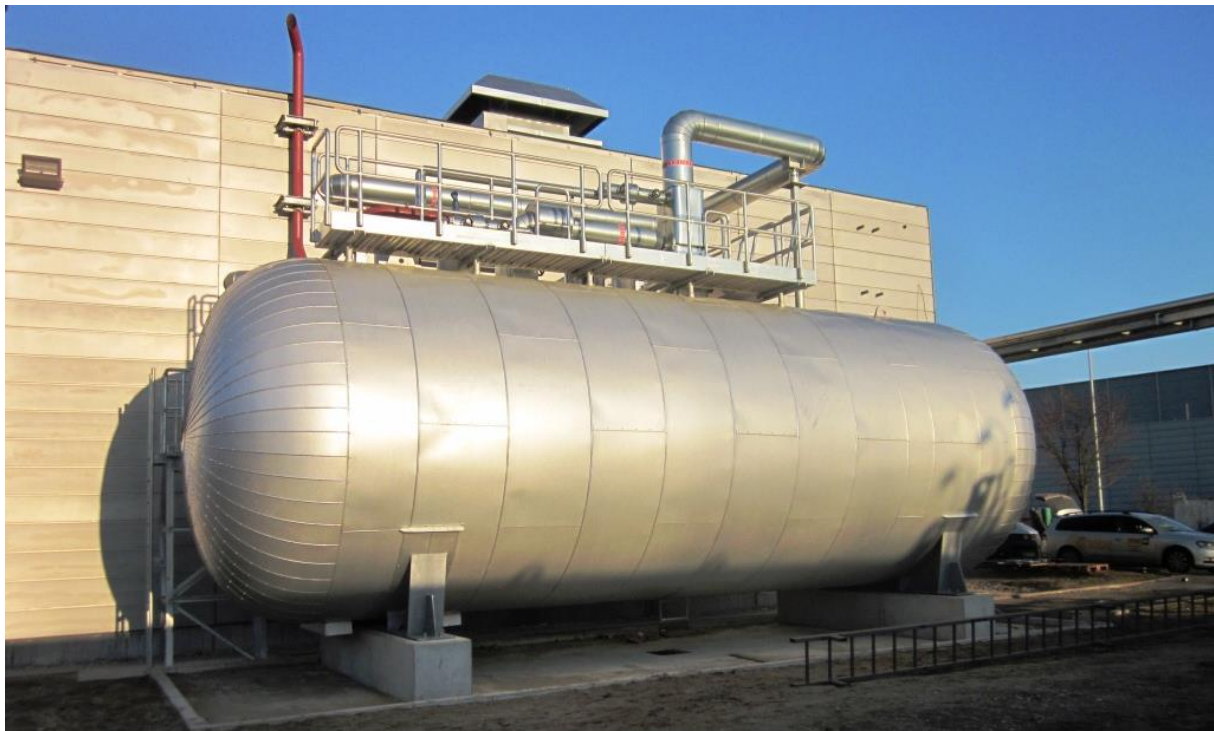
Bild 1: Dampfspeicher vor dem Kesselhaus
