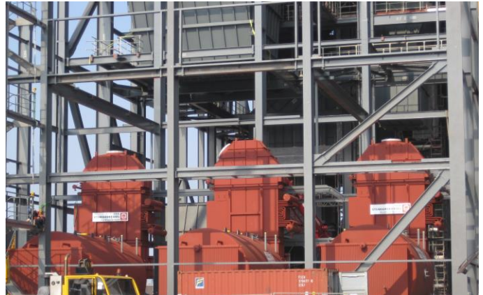
Bild 1: Hilfskesselanlage Rotterdam, nach der Einbringung. Der Speisewasserbehälter wird auf einer Ebene oberhalb der Kessel aufgestellt.
