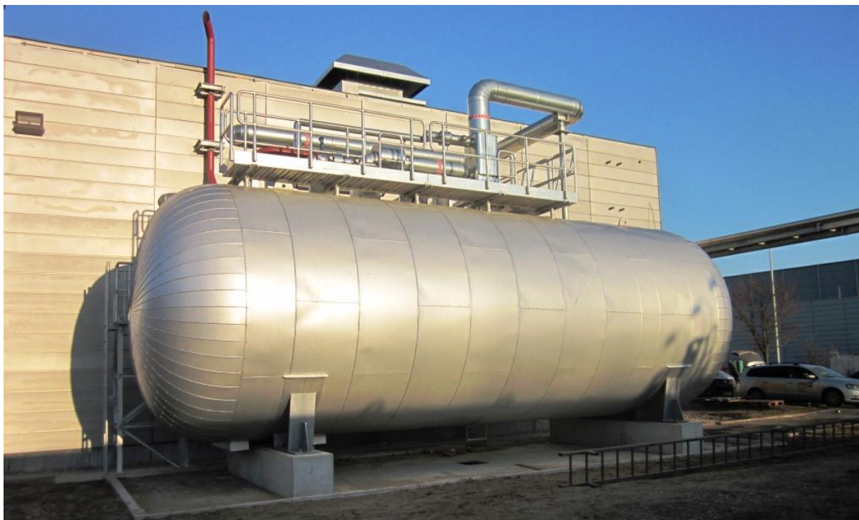
Bild 1: Dampfspeicher vor dem Kesselhaus
