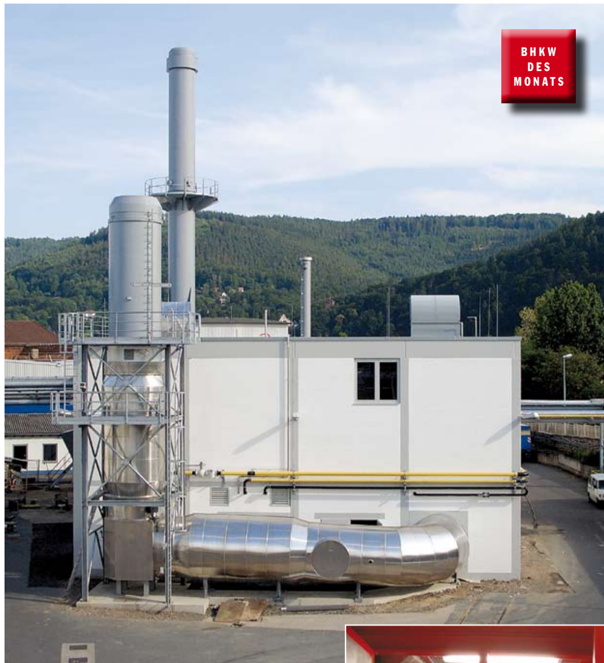
Wärmecontracting für Fripa in Miltenberg: Gasturbinen-Heizkraftwerk der Eon Bayern Wärme
