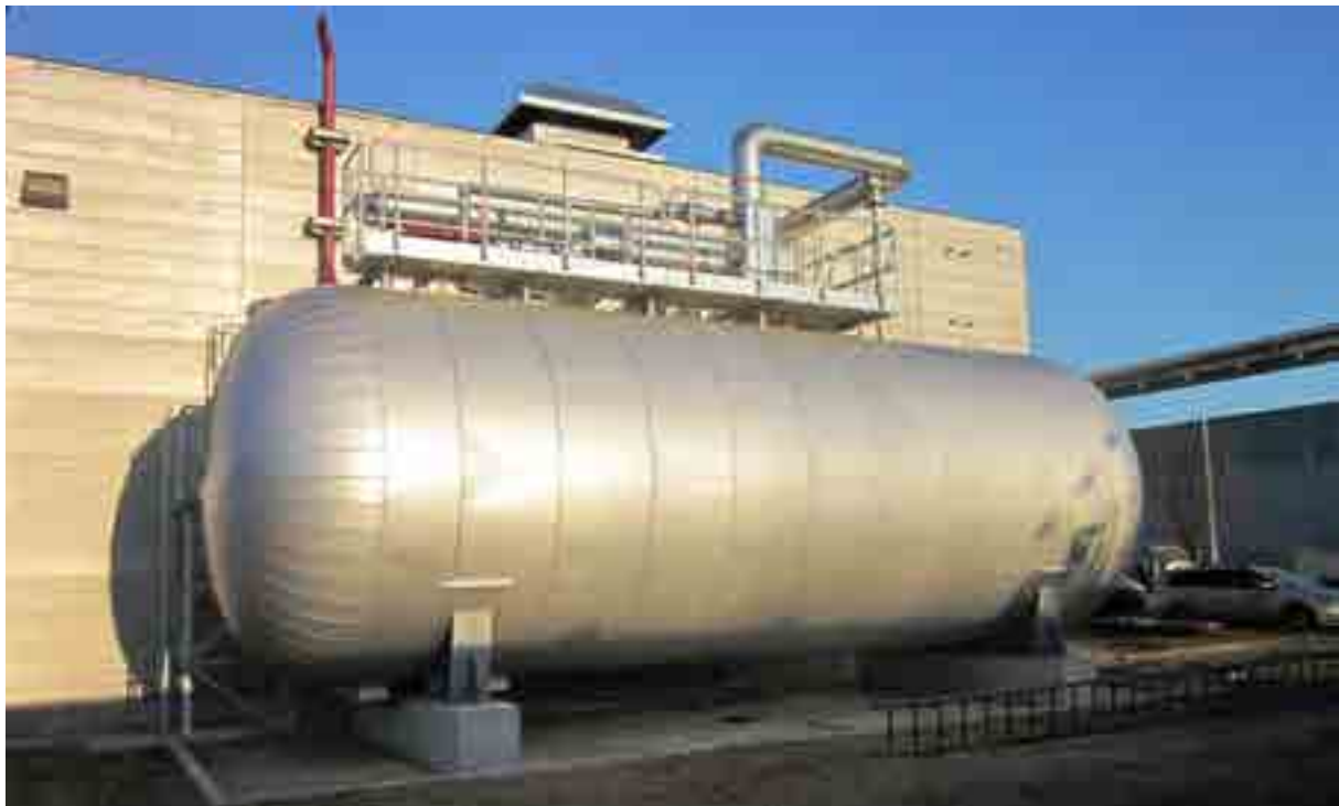
Bild 1: Dampfspeicher vor dem Kesselhaus
