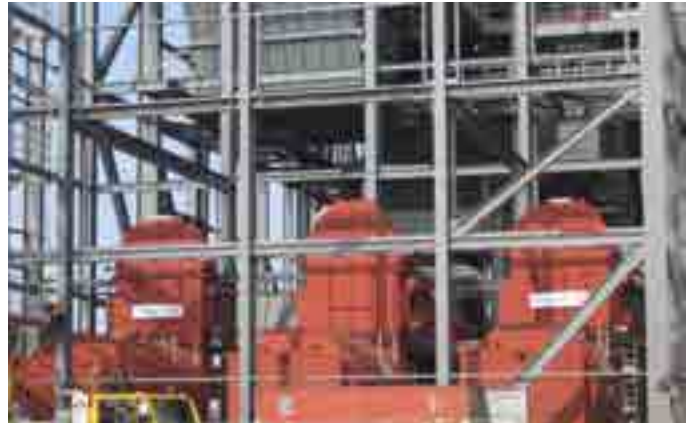
Bild 1: Hilfskesselanlage Rotterdam, nach der Einbringung. Der Speisewasserbehälter wird auf einer Ebene oberhalb der Kessel aufgestellt.
